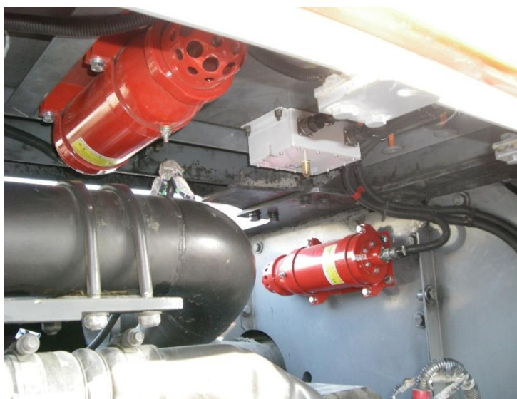
Рис. 2. Модуль порошкового пожаротушения
