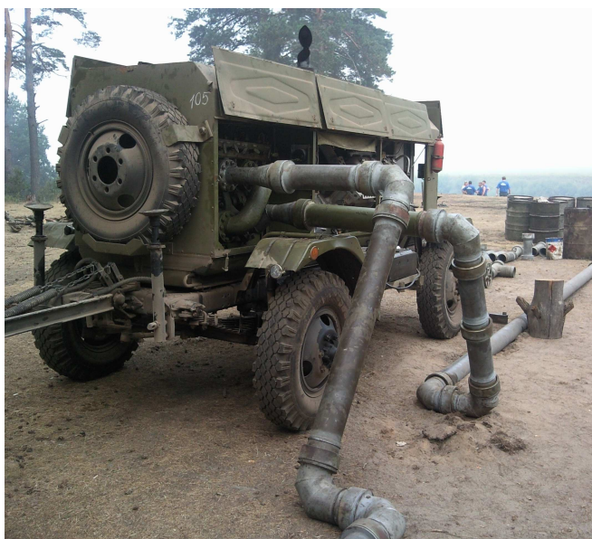
Рис.2 Передвижная насосная установка ПНУ-100/200 (второго подъема)
